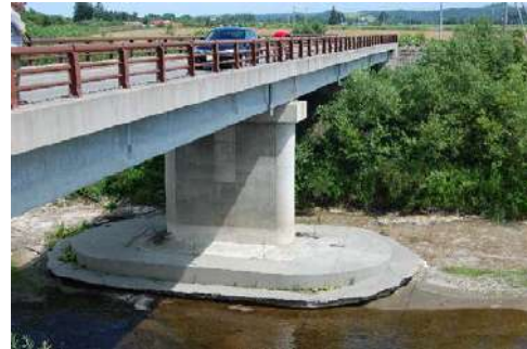
浦幌川の河床低下の様子
